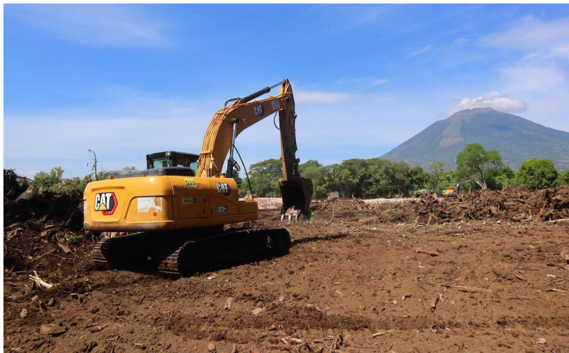
La organización también ha denunciado que numerosas piezas arqueológicas estarían quedando soterradas como consecuencia de las obras. Foto Diario Co Latino / Cortesía
