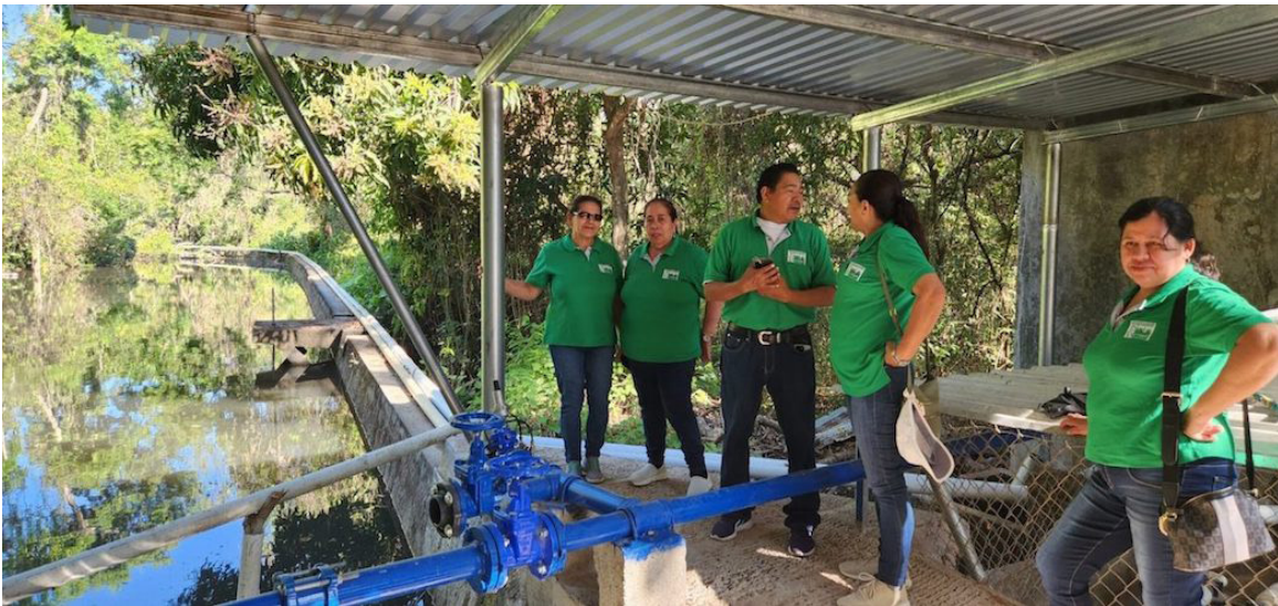
Se instalaron paneles solares que ahora generan la energía necesaria para el sistema de bombeo, lo que fortalece la sostenibilidad del proyecto. Foto Diario Co Latino / Cortesía
