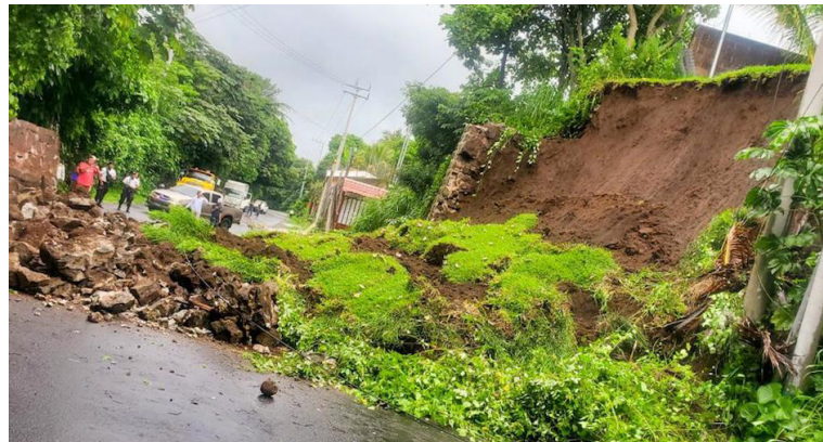
Debido a las lluvias, el colapso de un muro bloqueó el paso vehicular, en la calle de Los Naranjos, cantón El Canelo, Nahuizalco, Sonsonate.
