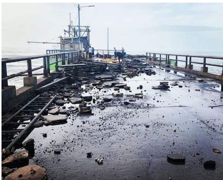
Las mareas altas en la costa salvadoreña hicieron estragos, en estructuras como el muelle del Puerto de la Libertad. FOTO DIARIO CO LATINO/CORTESÍA.
