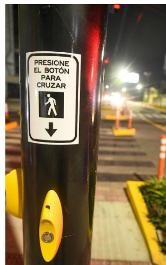
Cerca de 20 semáforos peatonales han sido instalados en la zona de la UES, Avenida Jerusalén y otros puntos del país, donde hay alta circulación de personas. FOTO DIARIO CO LATINO/@OBRAS-PUBLICASSV.
