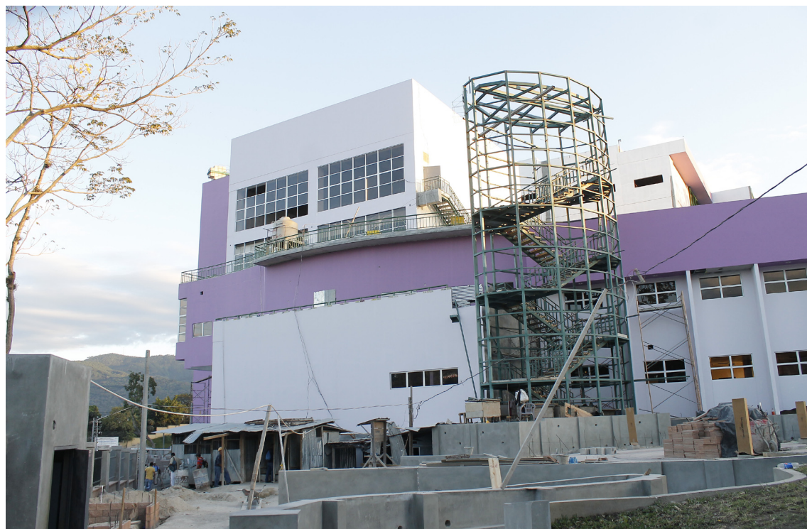
El nuevo Hospital de Maternidad se encuentra en un 90% de avance en su construcción. Foto Diario Co Latino/ Guillermo Martínez.
